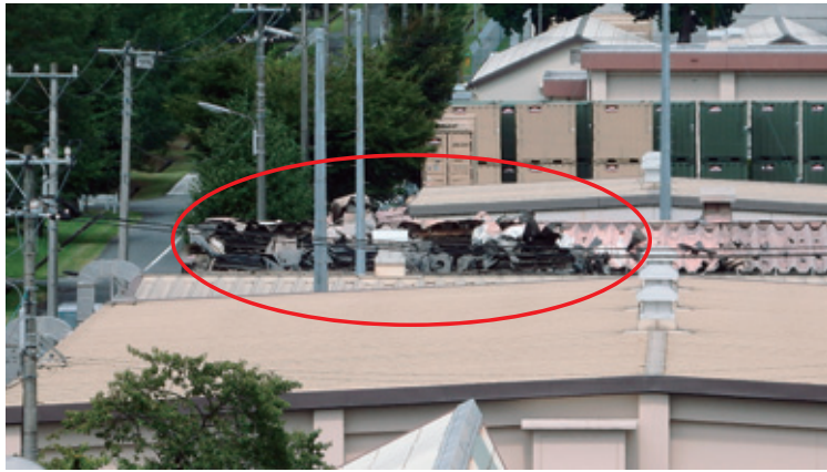
爆発により、屋根がめくれた倉庫 (8月24日午前、田所議員撮影)
