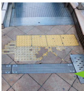
劣化した点字ブロック （橋本駅北口デッキ）
