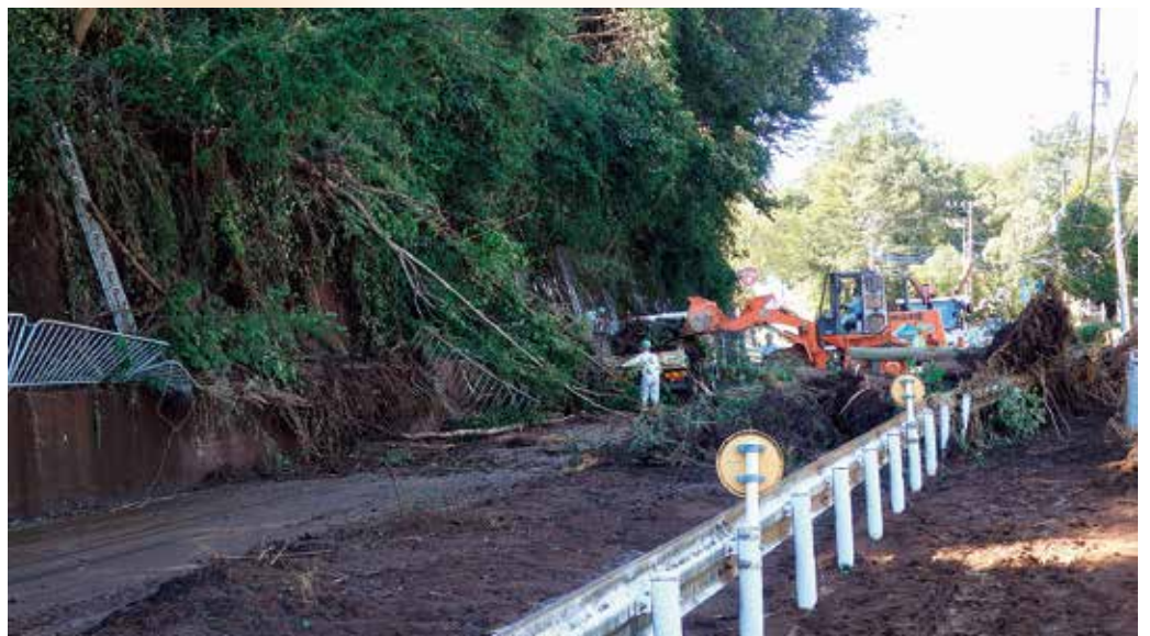
国道413号線での土砂崩れ(緑区三ヶ木)
