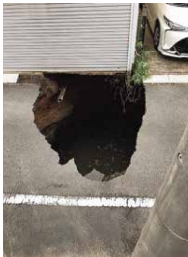
東京外環道の工事により陥没した現場（東京都調布市）
